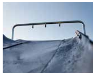
Wassersprühsystem mit Pumpe für effiziente Staubunterdrückung
